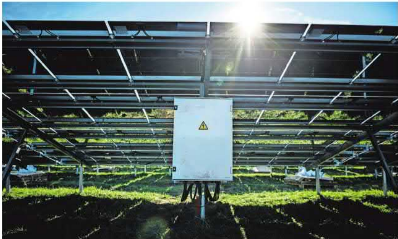
Aanleg van een zonnepark bij industriegebied Roodehaan in Groningen. FOTO KEES VAN DE VEEN
