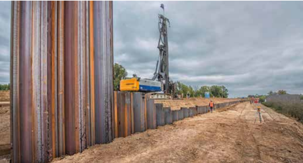
Damwand tegen piping (Opheusden).
