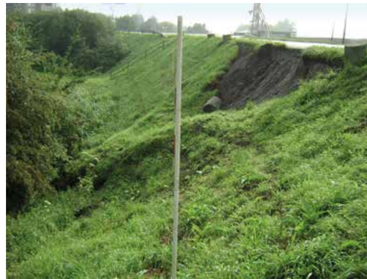
Afschuiven talusbekleding door hoge waterspanning in de dijk.
